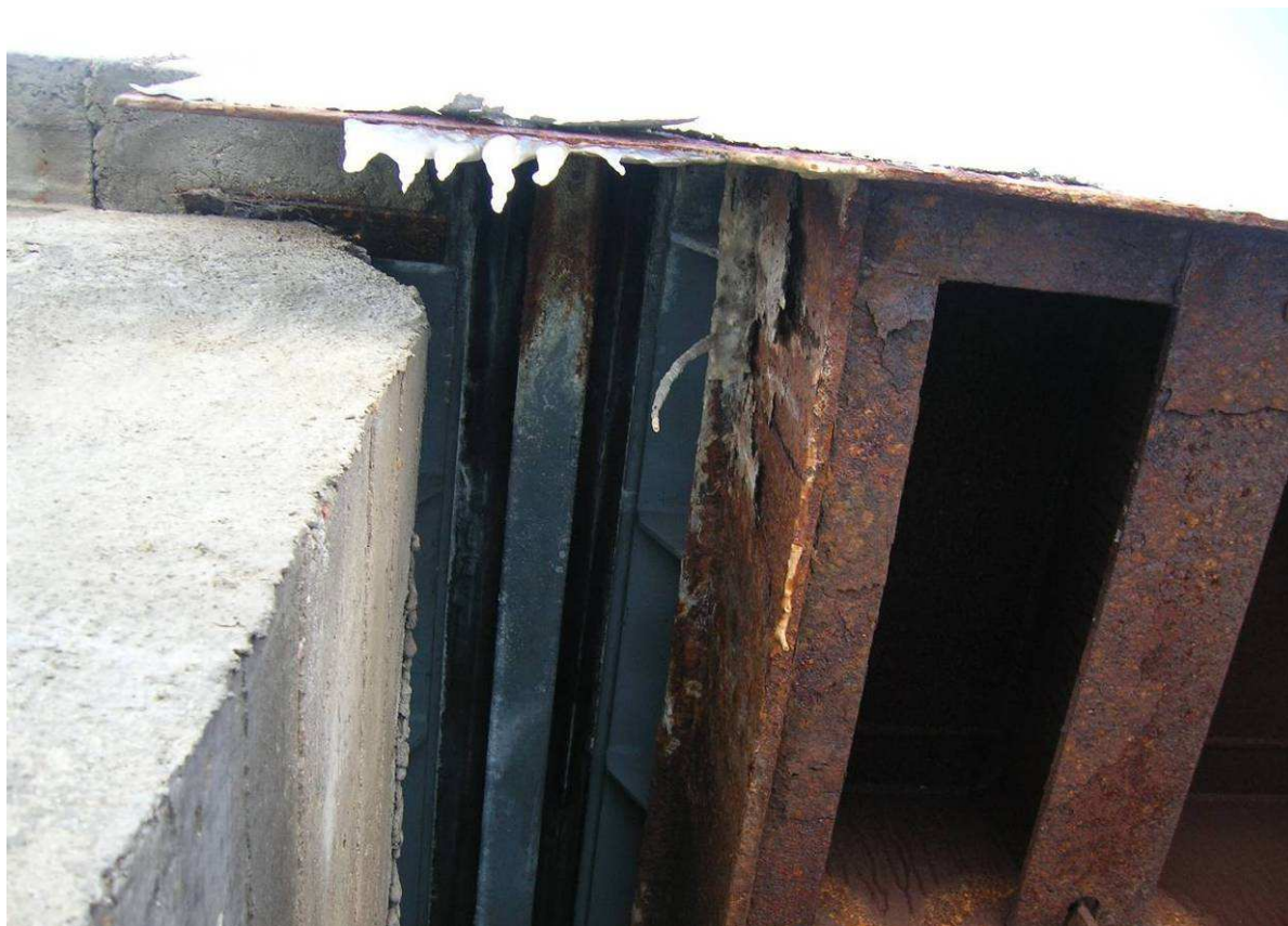
OBRÁZEK 7 – Koroze dolní pásnice mostu a stěny s vrstevnatými korozními produkty – detail u mostního závěru, silniční most, městské prostředí. Zatékání přes netěsný mostní závěr.
