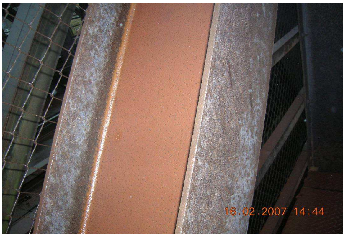
OBRÁZEK 4 – Koroze šikmé diagonály hlavního nosníku mostu, majitel byl nucen z důvodu oslabení stěny doplnit konstrukci nátěrem po 20 letech zabudování. Oslabení do 1000 \mu\text{m} s důlkovou korozí do 1000 \mu\text{m} , rok výroby 1979. Stáří mostu 27 let. Železniční most, venkovské prostředí.
