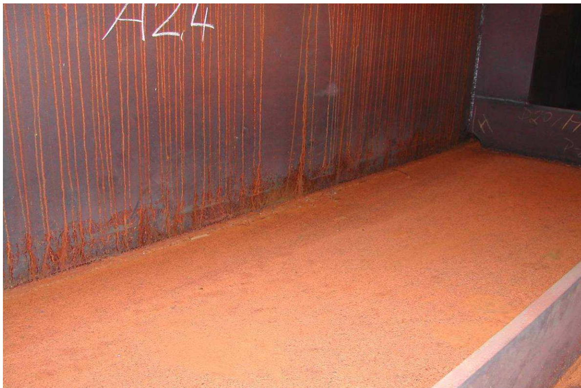
OBRÁZEK 3 – Koroze dolní pásnice mostu z obrázku 1 a 2 uvnitř komory, oslabení do 1000 \mu\text{m} s důlkovou korozí do 5000 \mu\text{m} , rok výroby 1991, stav za 16 let. V roce 2007 byly konstrukce opatřeny uvnitř komor mostu dodatečnými nátěry. Silniční most, městská atmosféra.
