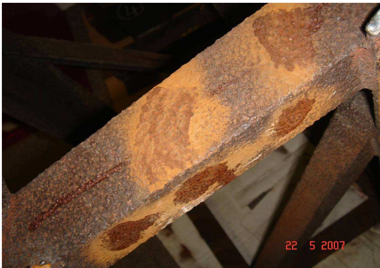
OBRÁZEK 10 – Detail důlkové koroze příhradové konstrukce roštu, stáří 31 let, oslabení do 1500 \mu\text{m} . Konstrukce byla v roce 2007 sešrotována.
