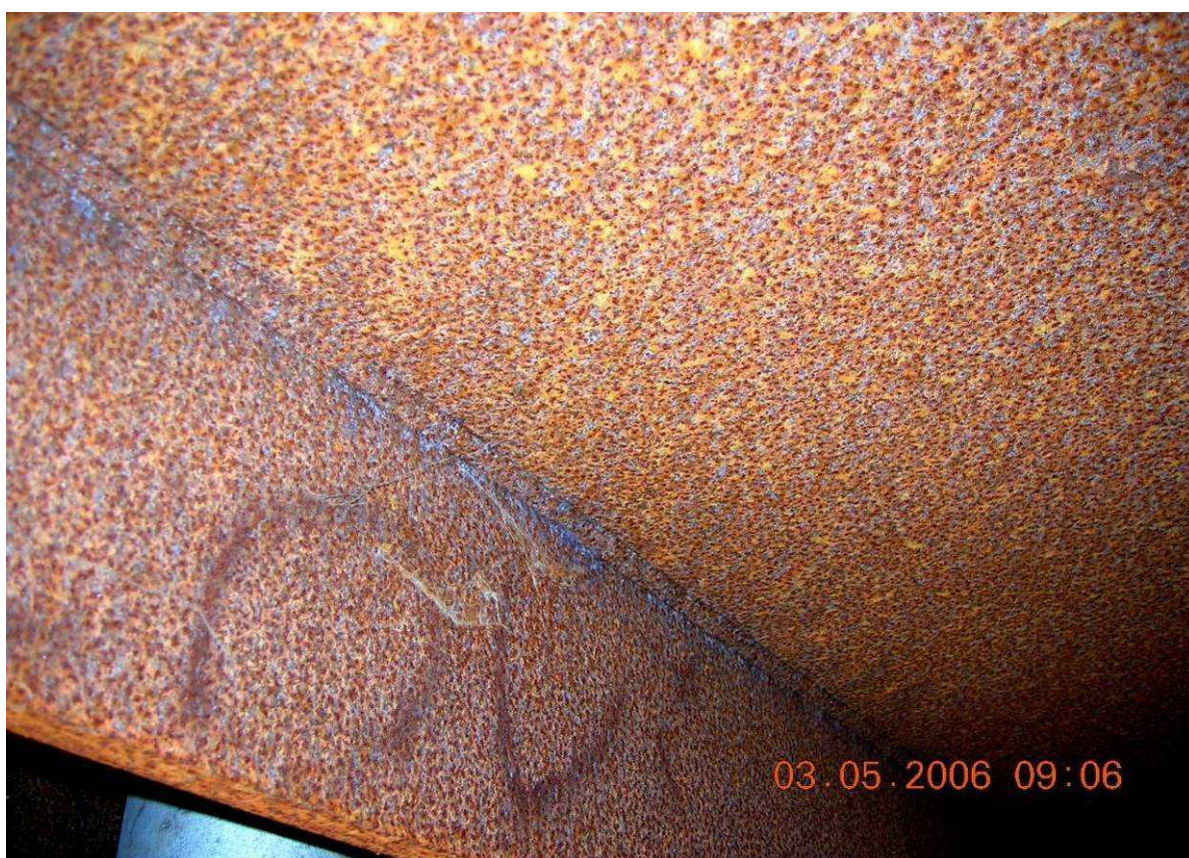
OBRÁZEK 8 – Detail struktury dříkové koroze pod ocelovou konstrukcí, žádná ochranná vrstva oceli se po 18-ti letech nevytvořila, železniční most, venkovské prostředí
