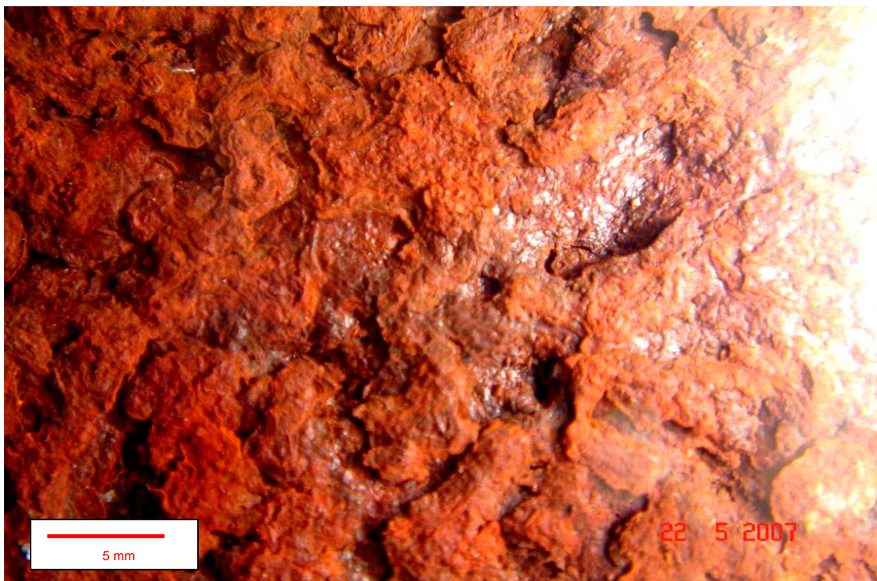
OBRÁZEK 6 – Koroze dolní pásnice mostu – detail struktury.
