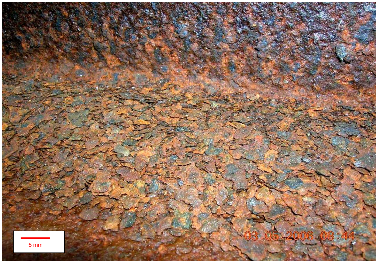
OBRÁZEK 5 – Koroze stěny v celé délce (30m) hlavního nosníku mostu u dolní pásnice, charakter koroze – lístková struktura s odlučováním vrstevnatých korozních produktů od podkladu, velikost odloučených lístků 3-6 mm, oslabení stěny do 2000 \mu\text{m} , oslabení koutového svaru až 3000 \mu\text{m} . Stáří mostu 17 let. Železniční most, venkovské prostředí.
